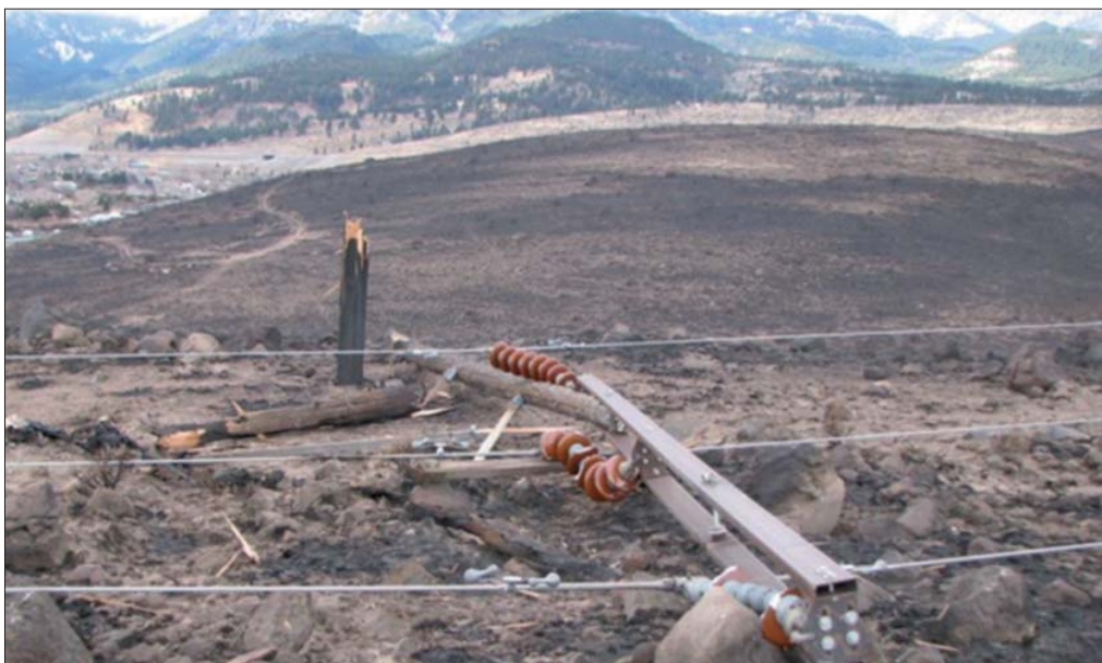
Figura 5 Conduttore ACCC intatto e funzionante dopo l'incendio
